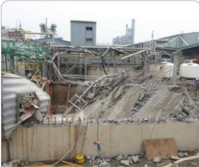
폐수 저장조 상부 배관 용접 중 폭발(사망 6, 부상 1)
